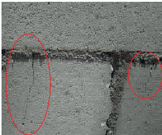
Fig. N° 12: Fisuras en unidades de albañilería
