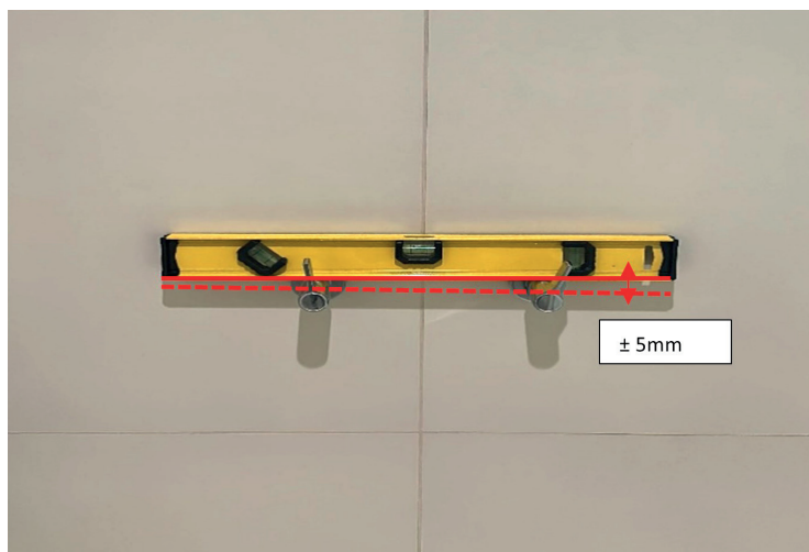
Fig. N° 67: Desnivel en salidas de griferías
