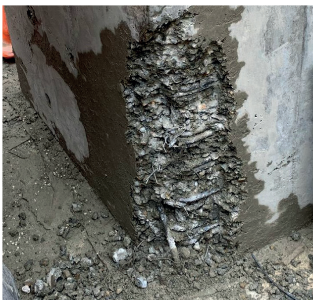
Fig. N° 3: Verificación de homogeneidad del concreto (segregación/cangrejera)
