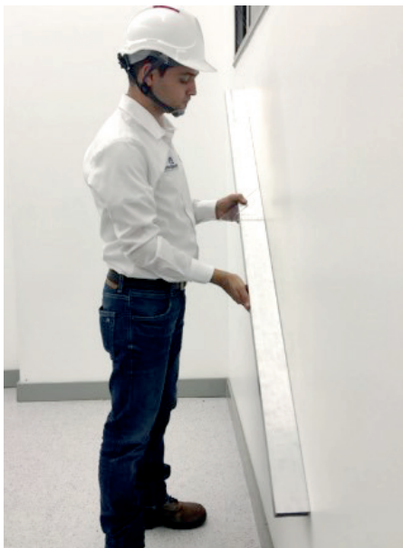
Fig. N° 28: Planeidad de tabique terminado
